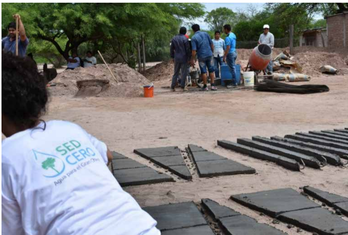
Foto 3. Sistema de cosecha de agua de lluvia construidos comunitariamente
